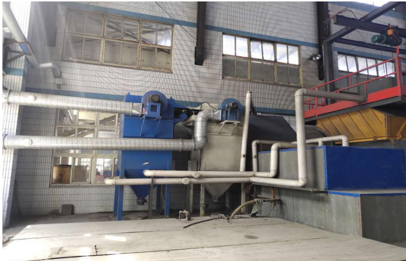
图 6-1 自保温砌块搅拌除尘器进口
